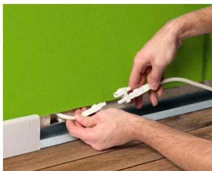
↑ De KBL-goot is onzichtbaar weggewerkt achter een afneembare plint.
