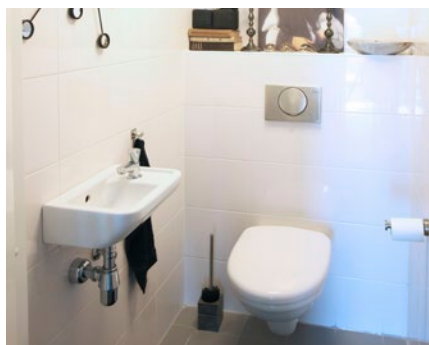
↑ Faay-wanden in de natte ruimten van de Wijnhaventoren (Den Haag).
